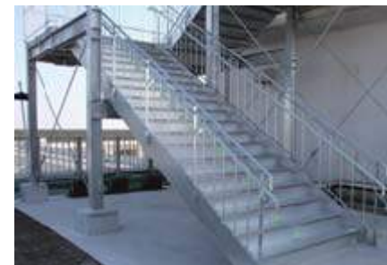
非常階段設置例
