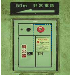
非常電話標示及び通報装置標示板
