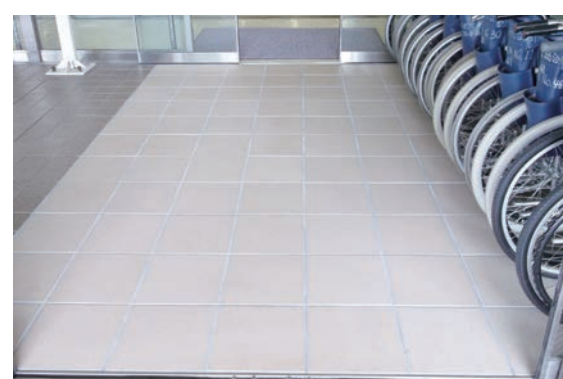
病院の風除室床材として使用
